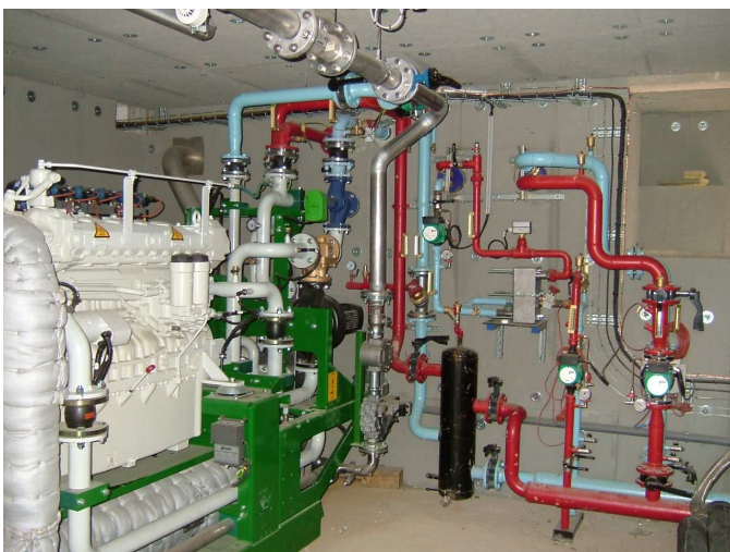
Photo 5 – réseau de chaleur : départs et arrivées [2]
