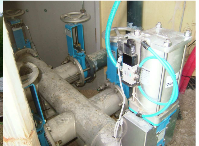
Photo 2 – canalisations de transfert du digestat [1]
