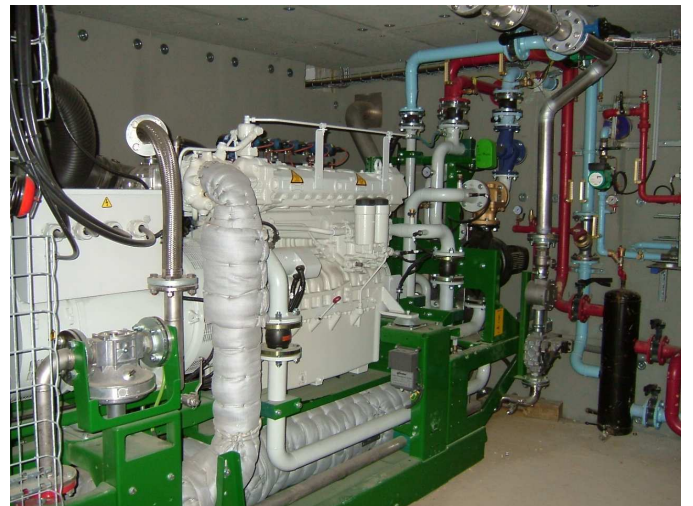
Photo 4 – moteur de cogénération [2]
