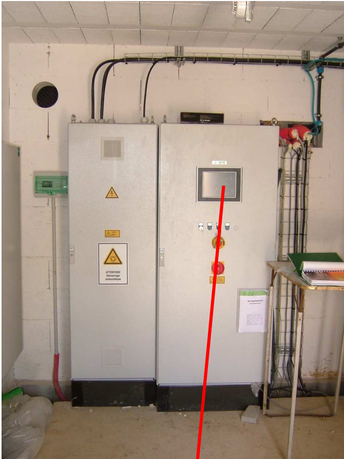
Photo 6 – armoires de contrôle et de pilotage de l'installation
