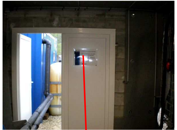
Photo 8 – panneau de présentation de l'unité de méthanisation apposé sur la porte du local de cogénération.
