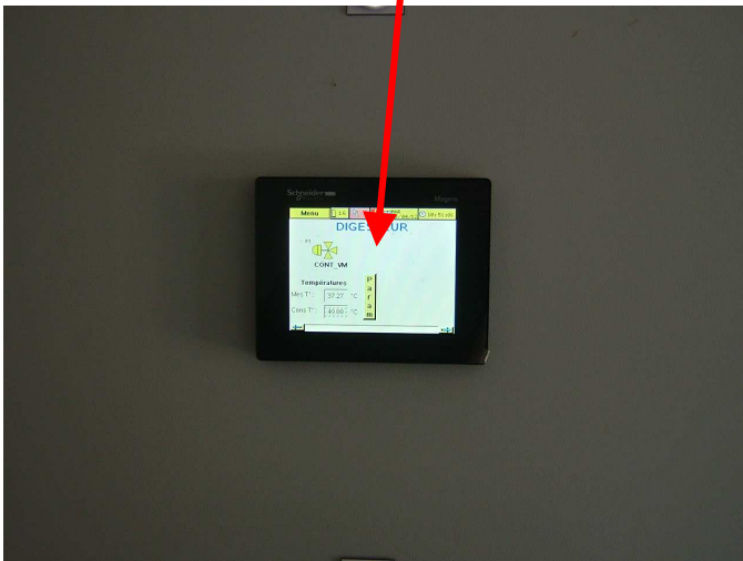
Photo 7 – Ecran tactile de commande et de contrôle de l'installation
